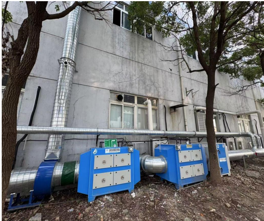
图5 回流焊、波峰焊废气处理设施
